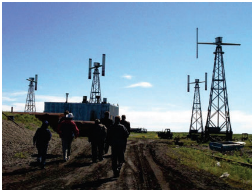
Ветроэлектростанции в поселке
